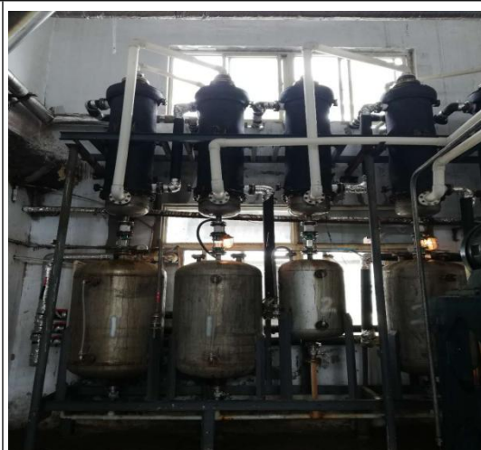
干燥冷凝、接收装置
